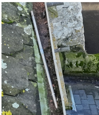
La pointe du paratonnerre qui heureusement est restée dans la gouttière
