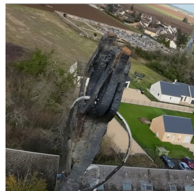
Le mat cassé de la croix qu'il faut maintenant démonter
